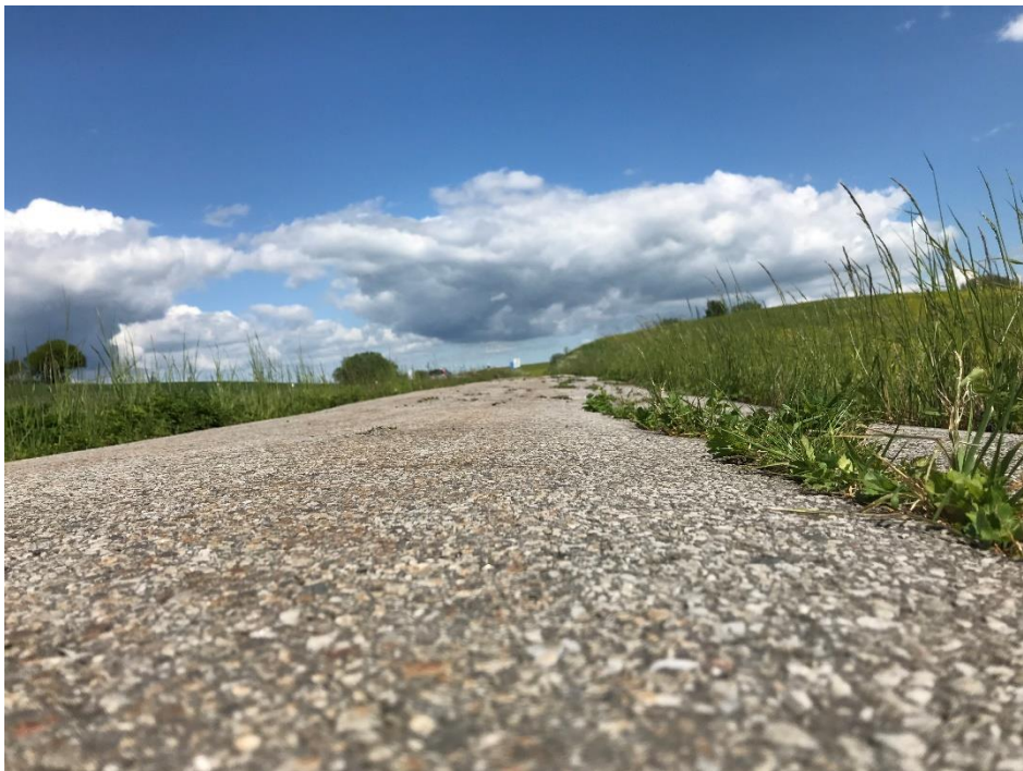
Figur 40: Cykelvägen mellan Minnesbergsvägen och korsningen med Aggarpsvägen/Elinedalsvägen (väg 595). Ytan är belagd men i dåligt skick.
